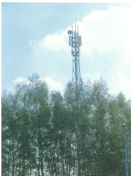
Zał. nr 1: Widok ogólny instalacji radiokomunikacyjnej.
